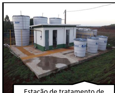
Estação de tratamento de efluentes líquidos (ETE) industriais de alta eficiência;
