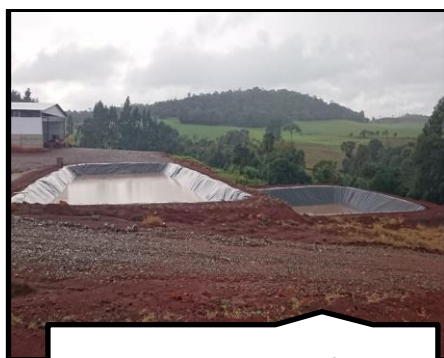
Lagoa de polimento final e lagoa de acumulação;
