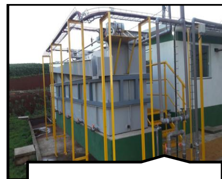
ETE - Reator de eletro-floculação e oxidação de alta eficiência;
